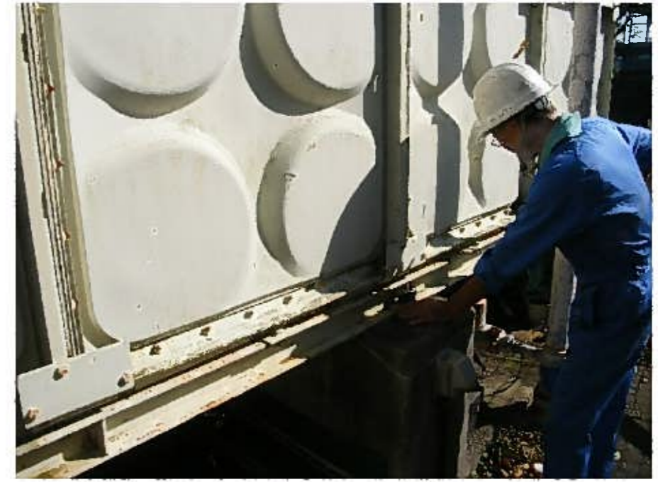
受水槽の周りを 放射能測定器で観測
